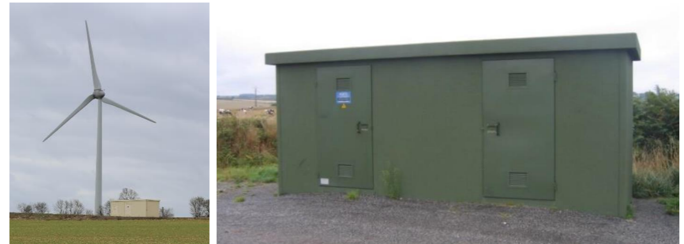
Figure 15 : Exemples de poste de livraison électrique
